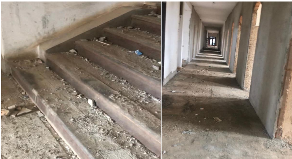
Tam cấp gỗ lên phòng áp mái đối diện phòng học lớp 7 và hành lang tầng 2
